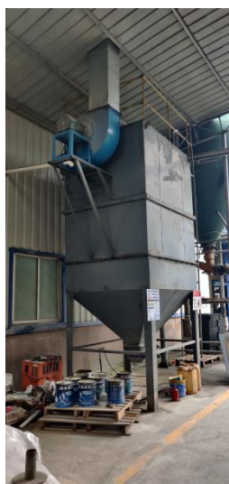
图 3-3 干粉腻子废气处理设备
