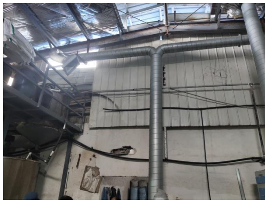
胶水废气管道
