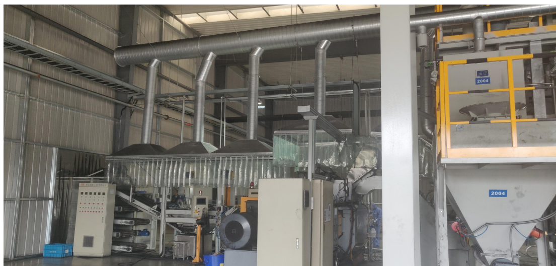
图 4-2 有机废气收集管道
