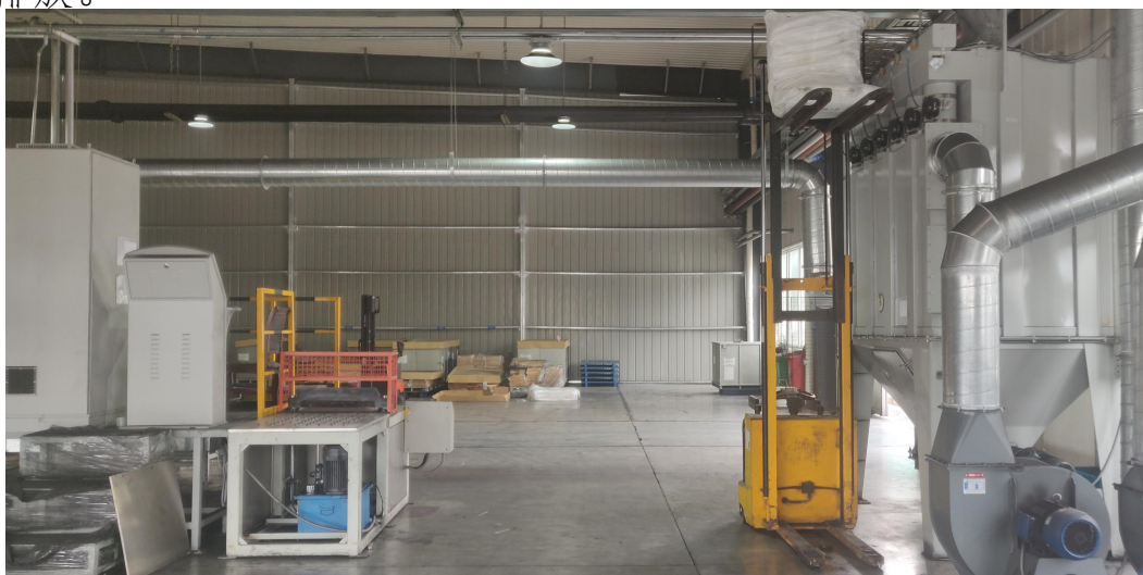
图 4-1 配料粉尘管道及袋式除尘器
