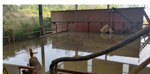
图5 废水收集池及循环水池
