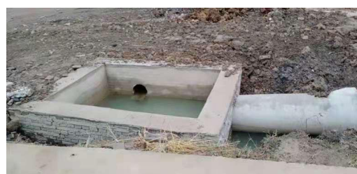
图6 场地雨水收集水池
