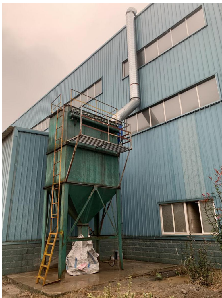
图 6-1 废气处理设施
