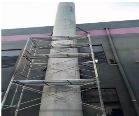
图 3-4 天然气锅炉处理设施排口
