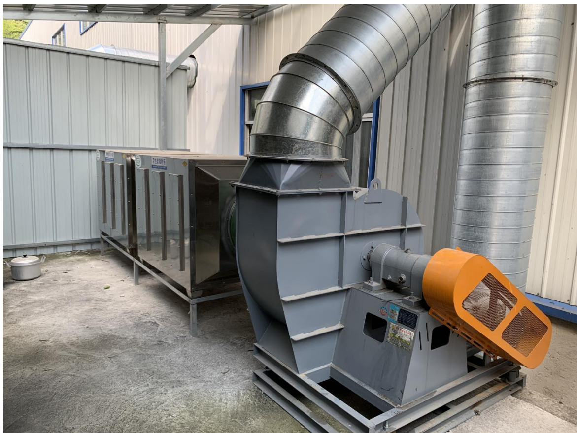
图 6-1 废气处理设施
