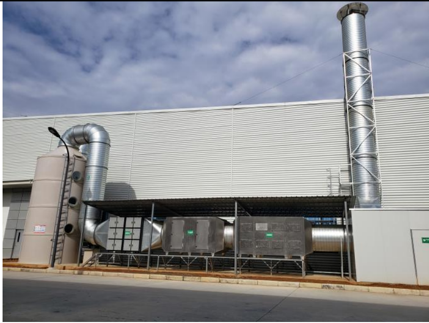
图 4：硫化废气收集及处理设施
