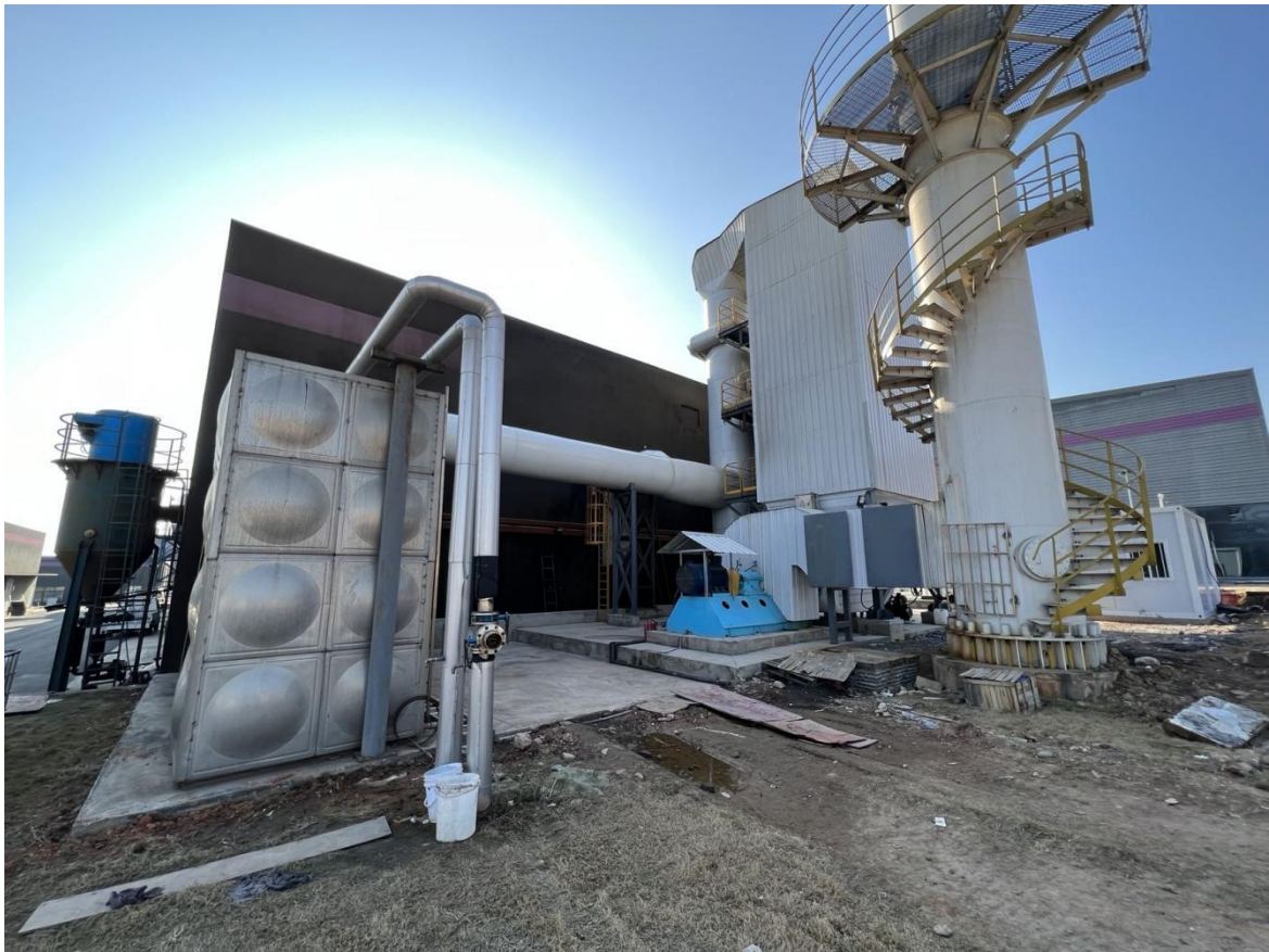
图 6-1 废气处理设施
