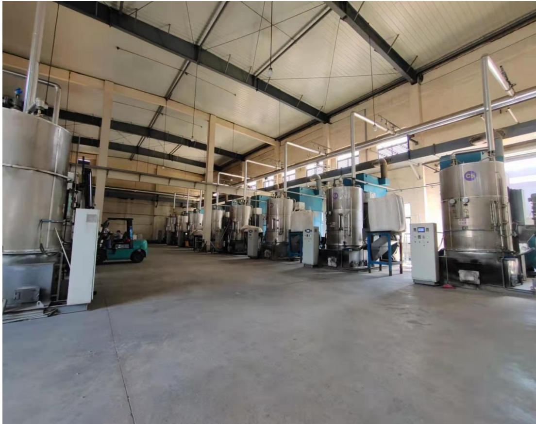
项目生物质锅炉
