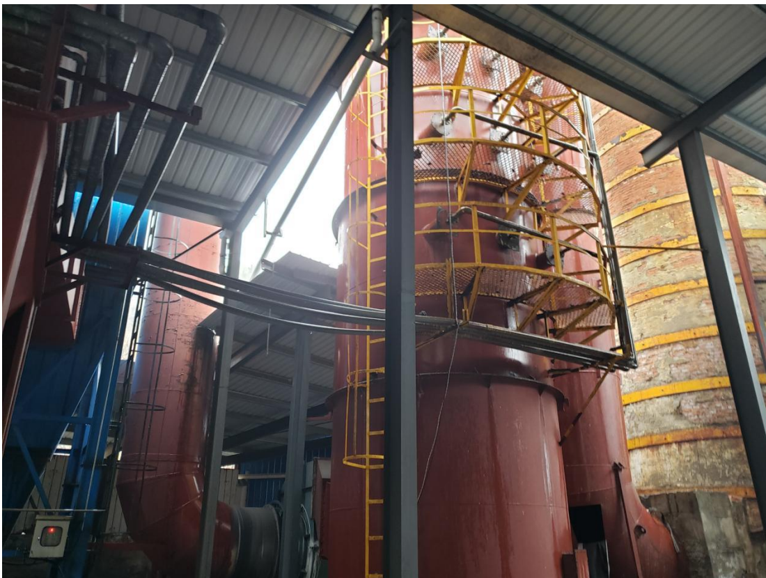
图 6-3：脱硫脱硝设备
