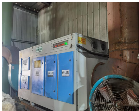
图 7-1 制芯废气处理设施
