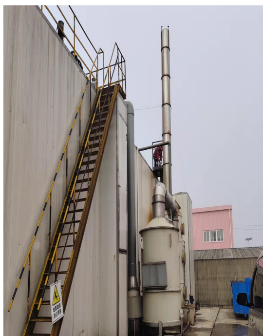
图 9：硫化床废气处理设施
