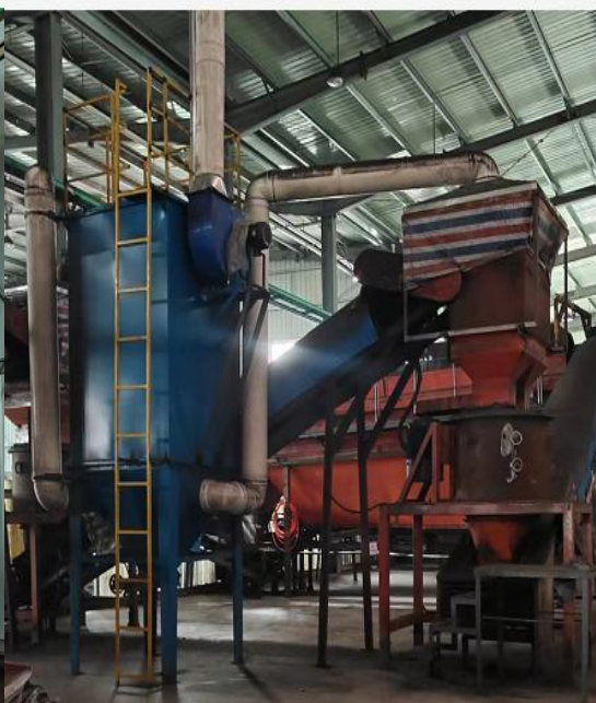
图 12:破碎机废气处理设施
