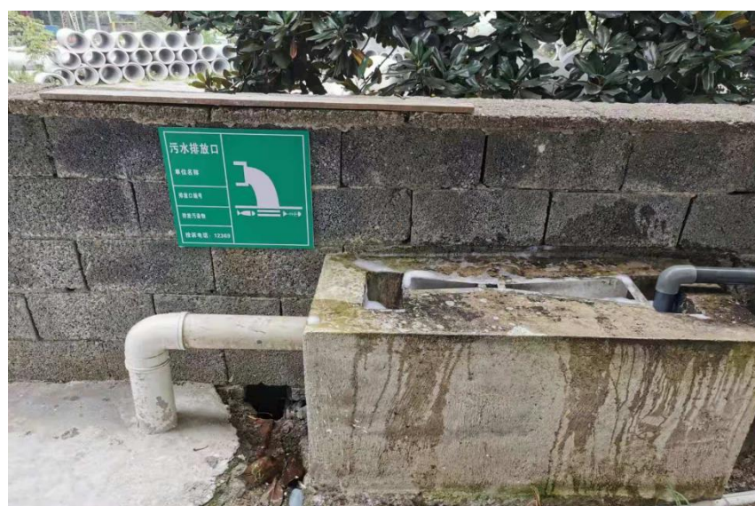
图 4-3 污水处理站排口
