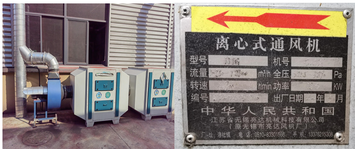
图 6-2 集气设施+两级活性炭吸附装置+1 根 15m 高排气筒
