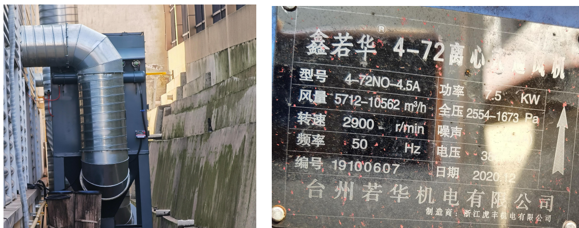
图 6-1 袋式除尘器+15m 排气筒
