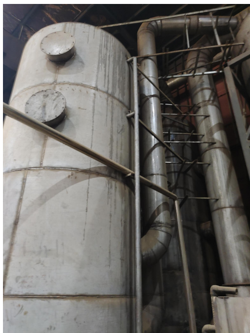
图 6-2 二级水喷淋+静电除尘器
