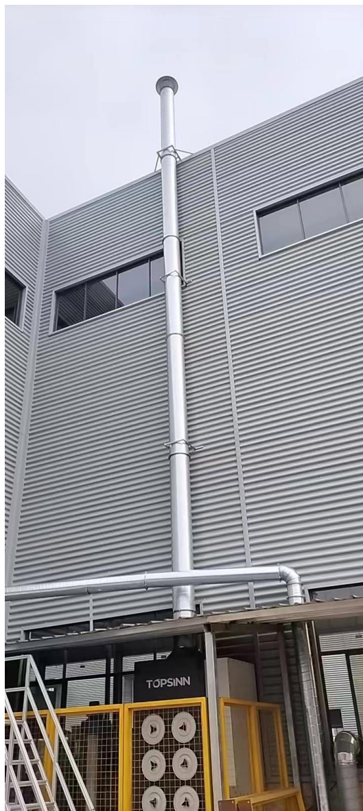
图 6-1 切割、焊接、打磨废气处理设施
