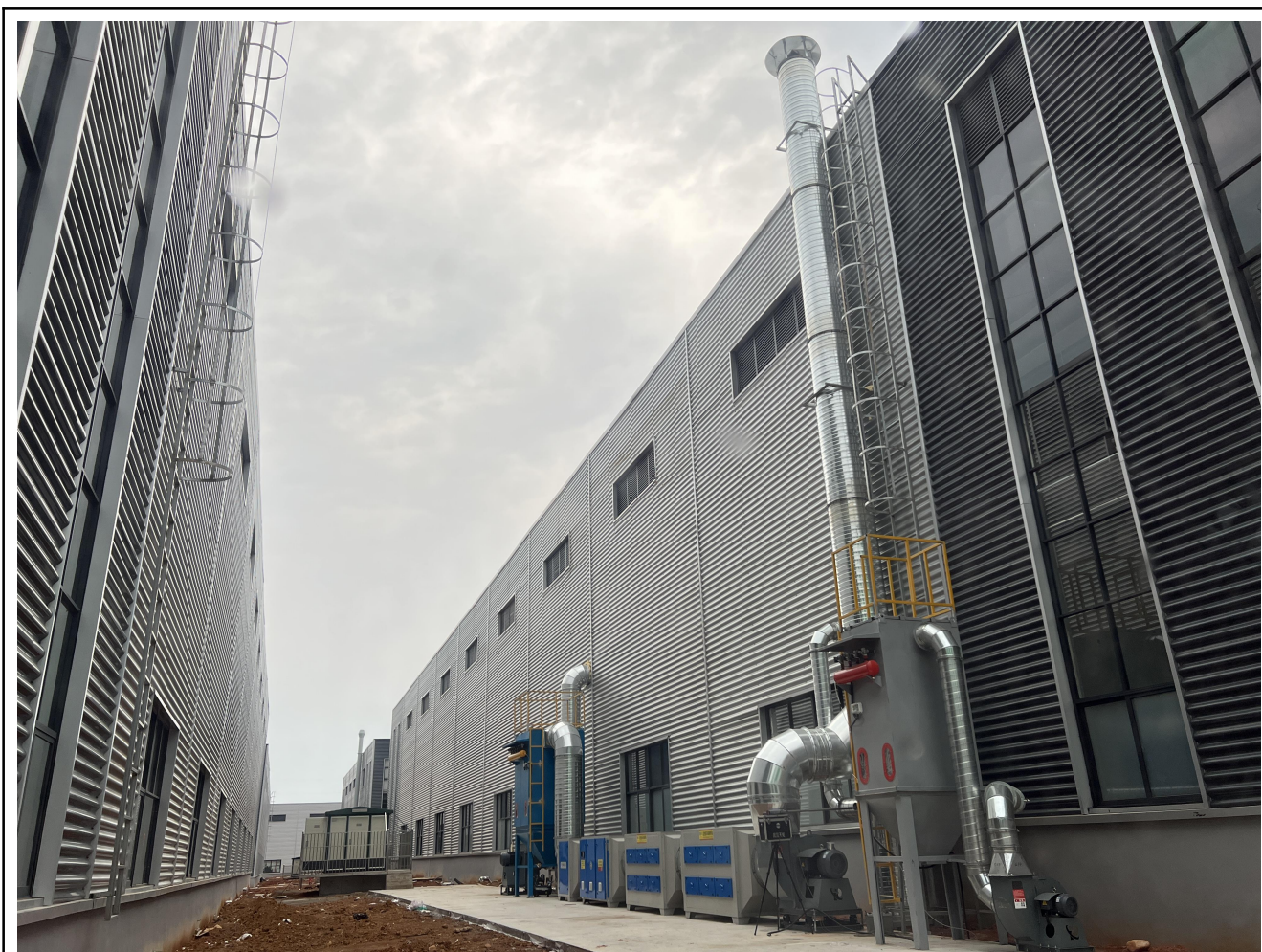
图6-3 布袋除尘器、干式过滤棉、UV光氧+两级活性炭处理
