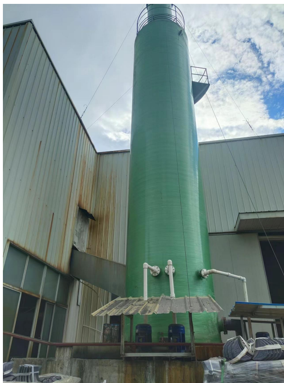
图 4-1 碱液喷淋设施
