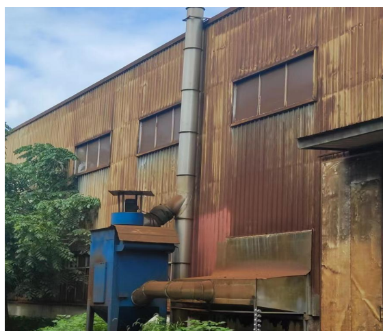
图 4-9 钻床废气处理设施图
