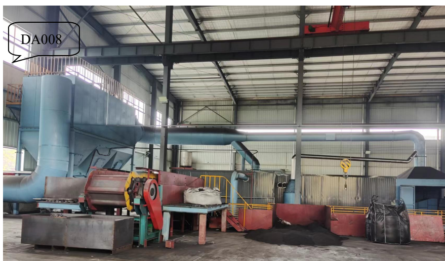
图 4-5 滚筒落砂废气处理设施
