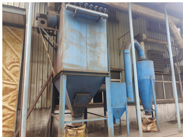
图 4-8 热风炉废气处理设施图
