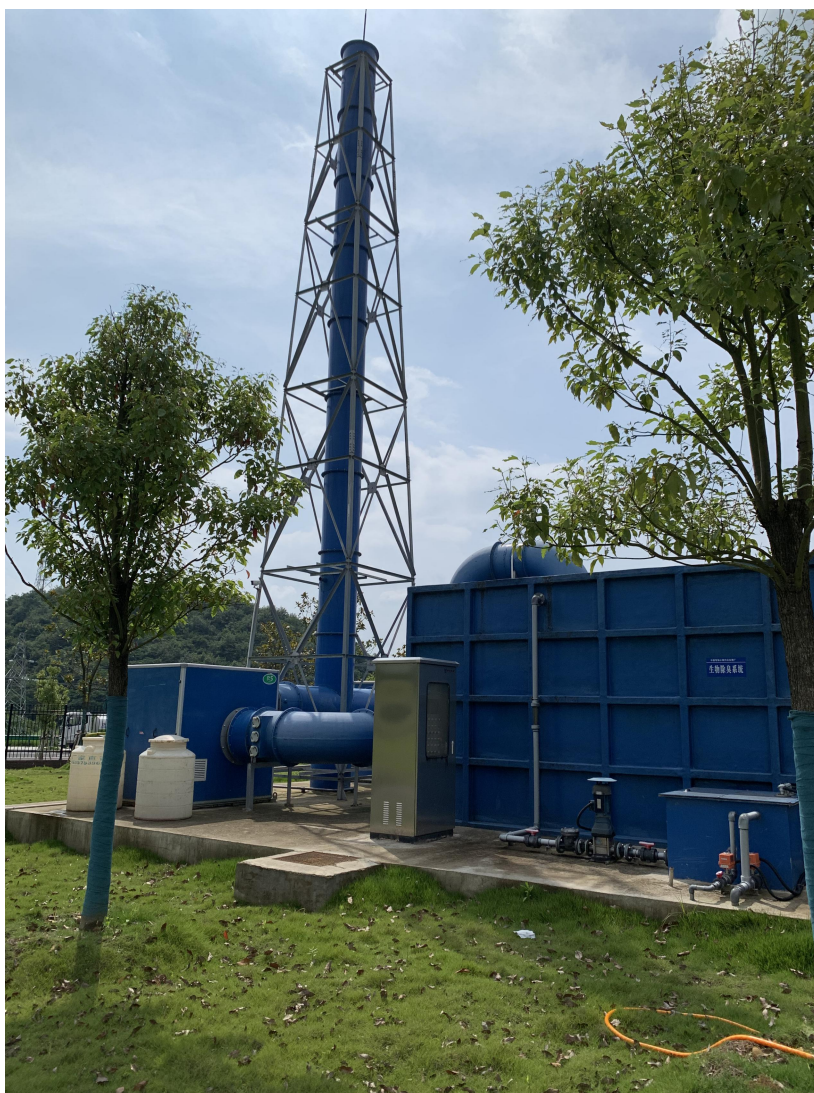
图 4-2 废气处理设施及排气筒
