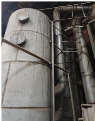
图 6-3 二级水喷淋+静电除尘器
