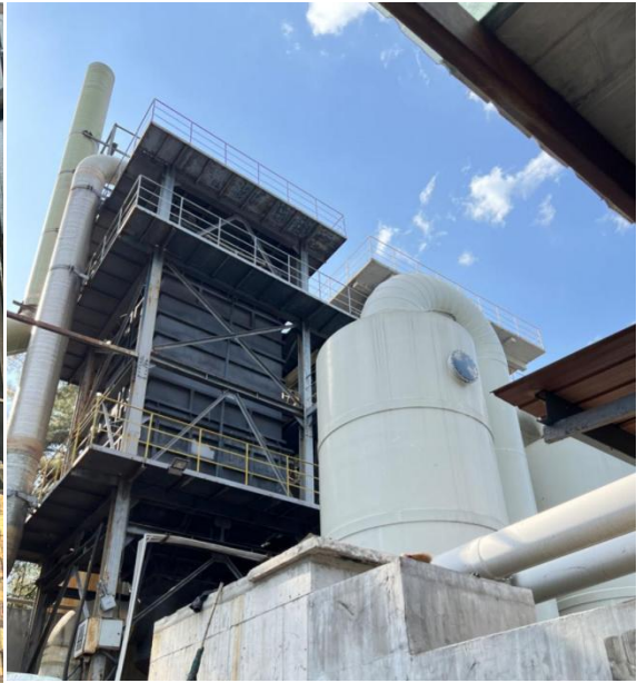
图 7-6 原、新生产线水喷淋、电除雾设施
