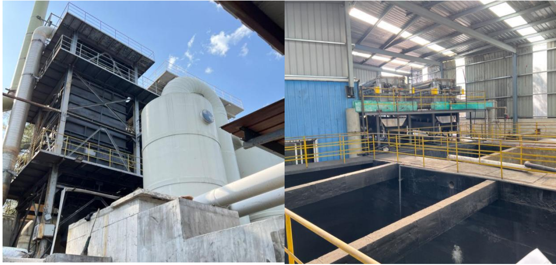
图 3-1 二级水喷淋+电除雾+20m 高排气筒
