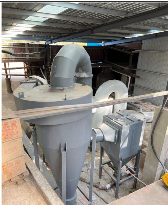
图 7-8 木屑筛分及干燥废气处理设施
