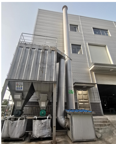
图 4-2 车床粉尘处理设施（4#排气筒）
