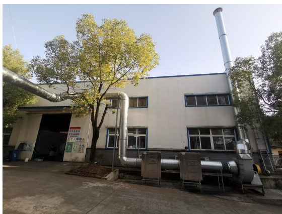
图 4-3 硫化废气处理设施（2#排气筒）
