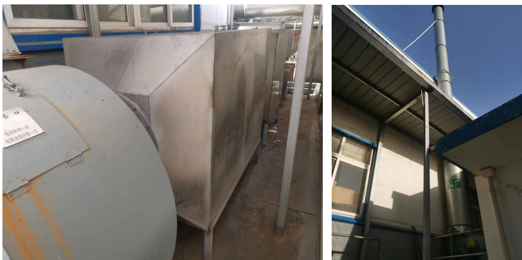
图 4-4 硫化、二段硫化废气处理设施（1#排气筒）
