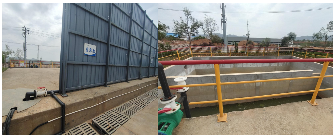
图 4-4 应急事故池及初期雨水池
