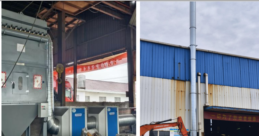
图 7-9 布袋除尘+二级活性炭（DA009）
