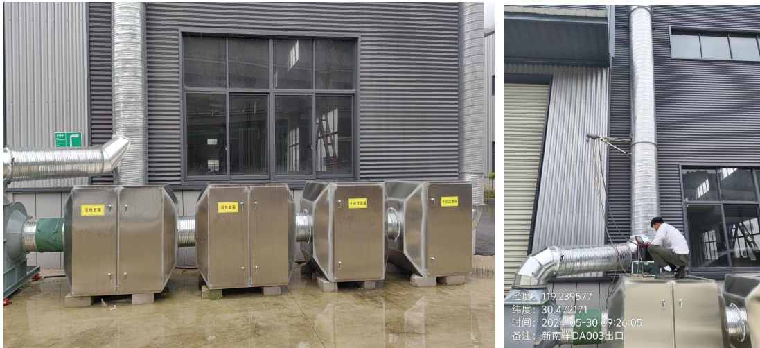
6-1 调漆、喷漆、晾干废气处理设施图
