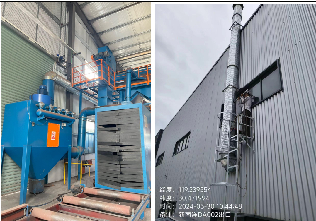
6-5 抛丸废气处理设施图
