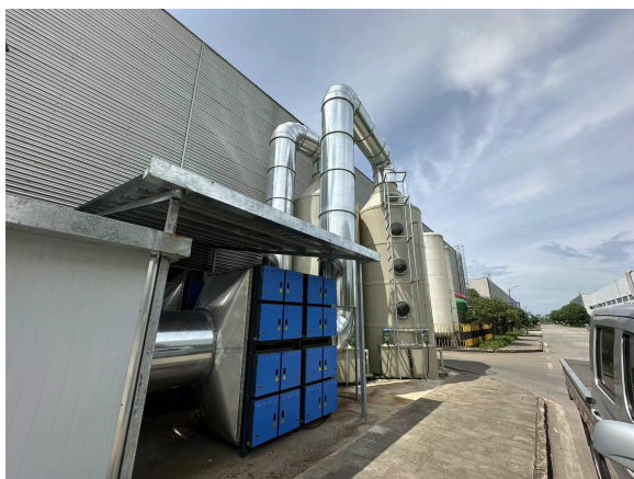
图6-1 焊接、打磨废气处理设施
