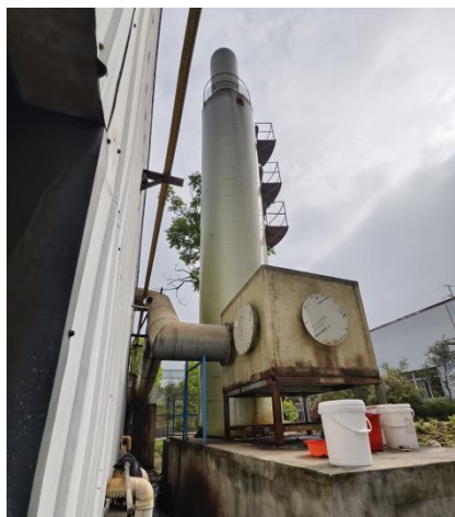
图6-1 烘干废气处理设施
