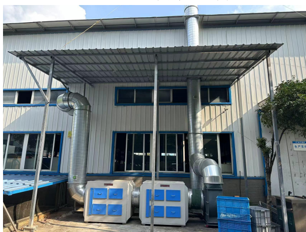
图 6-1 注塑废气处理设施
