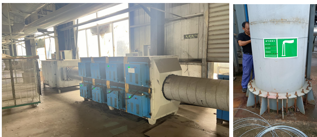
图 4-1 配胶、涂胶、晾干、烘干废气废气处理设施及废气排放口（DA001）
