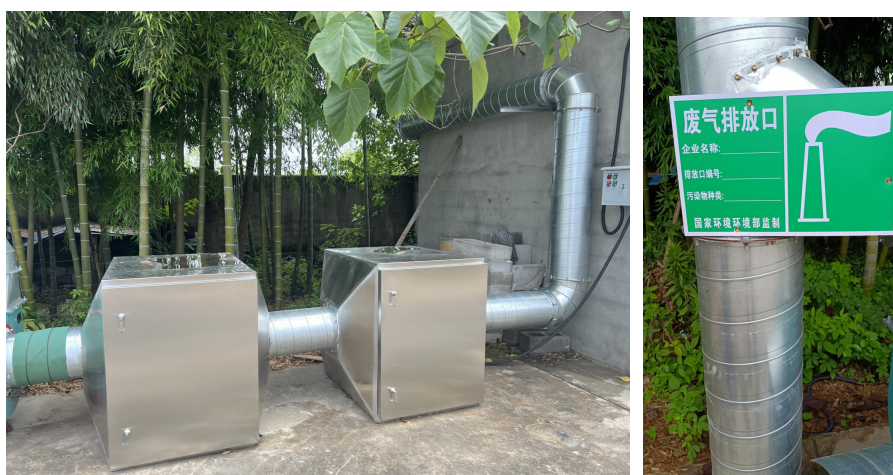
图 4-2 二级活性炭吸附设施及排放口（DA002）
