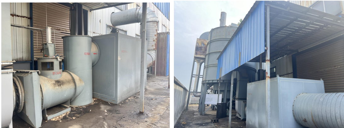
图 4-3 RTO 助燃废气处理设施
