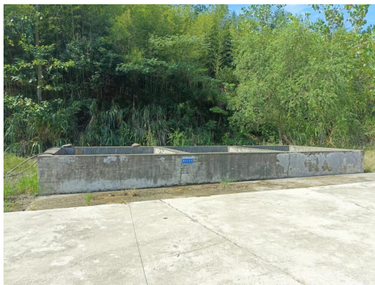
图 3-7-1 青龙 2 号养殖场事故应急池
