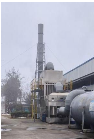
图6-1 淬火废气处理设施
